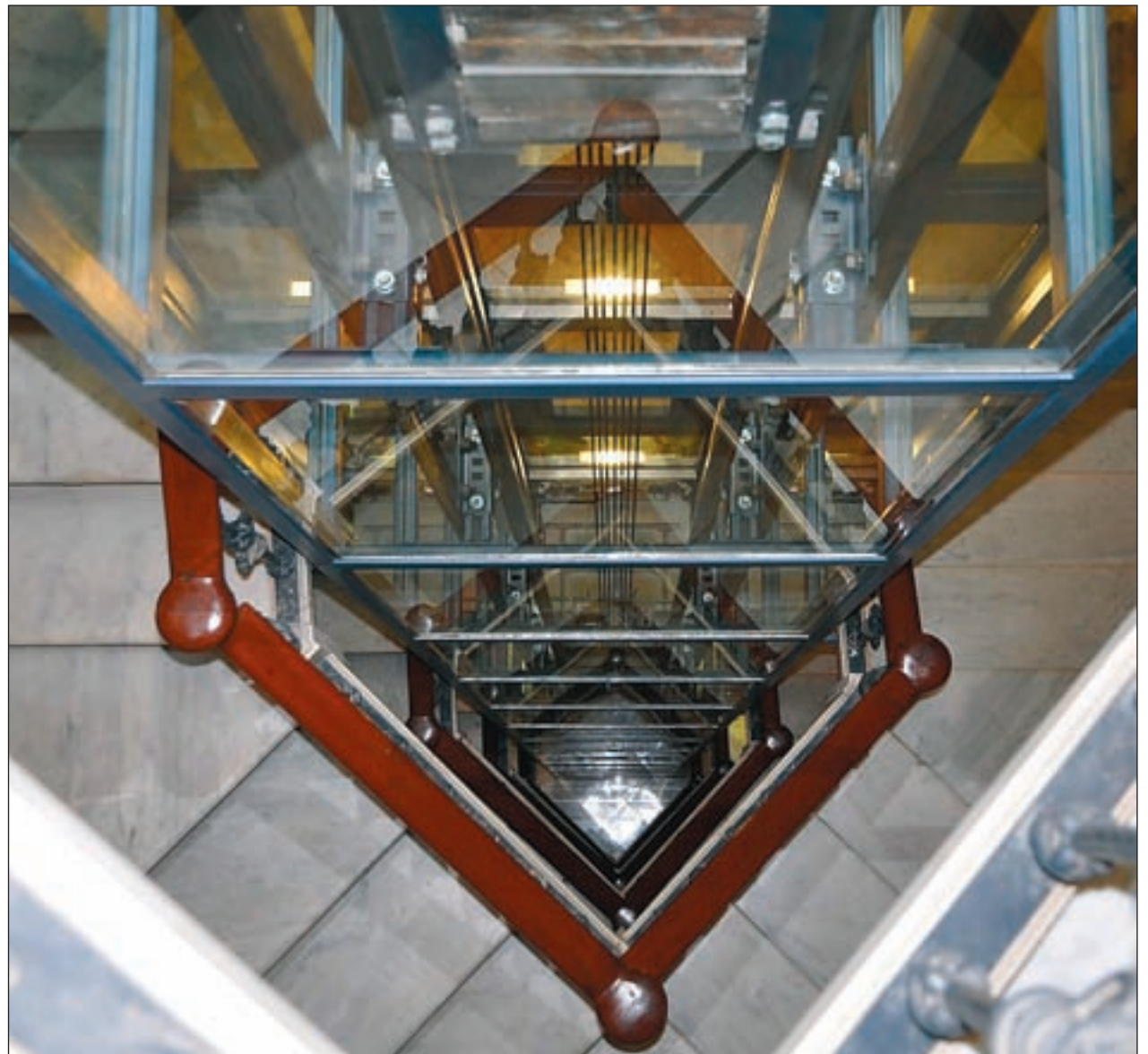
Ascensor instalado en el ojo de una escalera.
